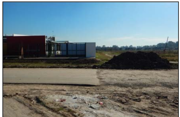
Punto culminación del pavimento en el límite exacto de la medianera del Jardín de Infantes N° 936.
