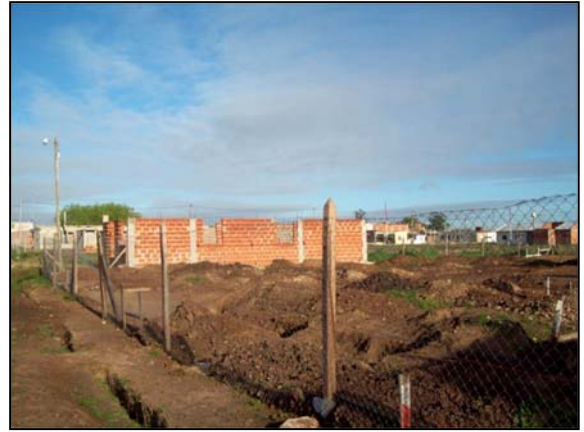
Obras inconclusas del Centro de Integración Comunitario (imagen 2017).
