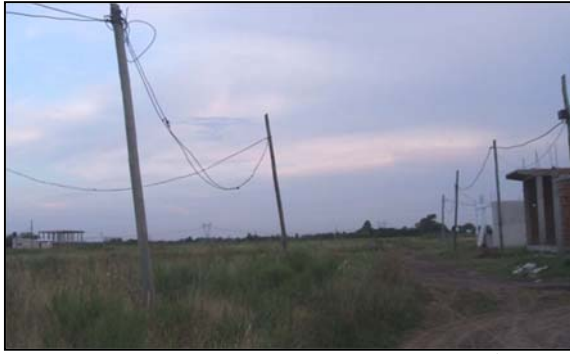
Conexiones irregulares en barrio Santa Mónica.
