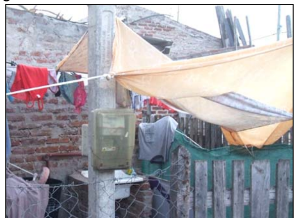
Medidor en vivienda de La Victoria.
