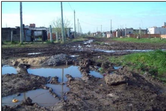
Anegamiento de calle interna de La Victoria. Imagen 2015.
