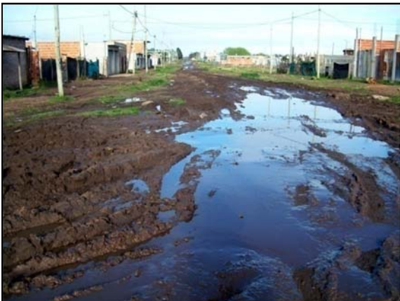
Anegamiento de calle interna de La Victoria. Imagen 2015.
