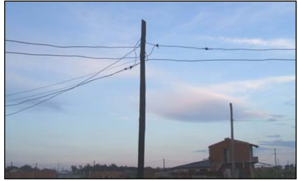
Bajada eléctrica en barrio Santa Mónica.
