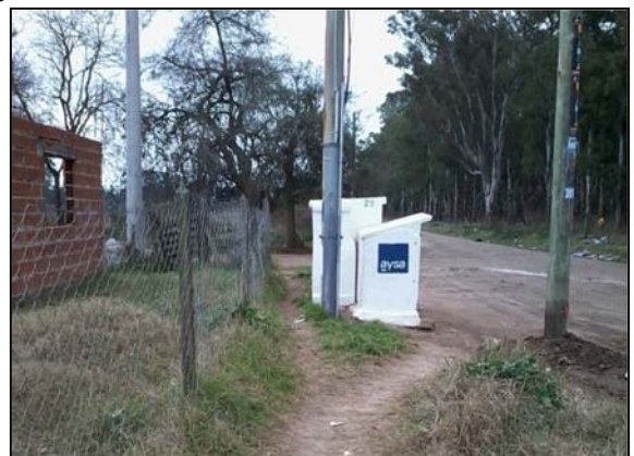
Estación de rebombeo de AySA SA sobre caño principal de calle Lavalle.
