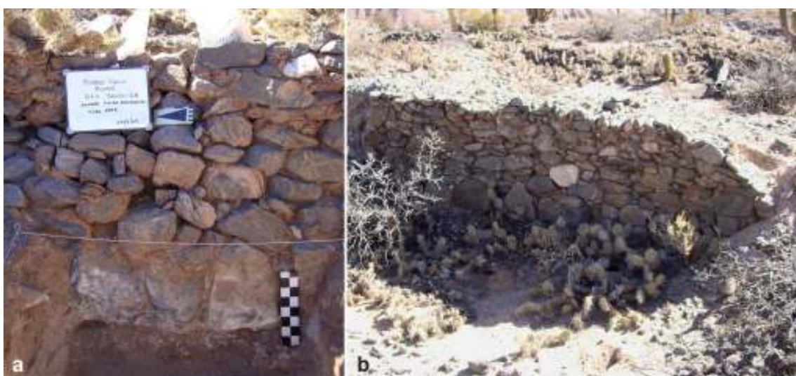
Figura 5.36. Muros empotrados de recintos subsuperficiales de Pueblo Viejo donde se observan las piedras grandes paradas utilizadas como cimiento. a) muro del Recinto 1a luego de la excavación; b) muro de estructura del sector Suroeste del sitio (fotografías de la autora).
