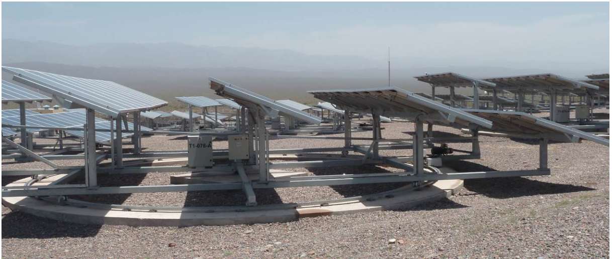
Figura 7. Parque solar Ullum, San Juan. Fuente: Carrizo, Forget 2014
