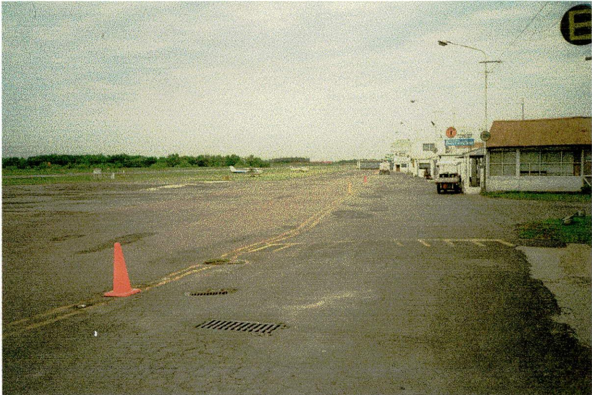
Foto 28: Calle de rodaje y acceso vehicular del Aeropuerto Internacional de Don Torcuato.
